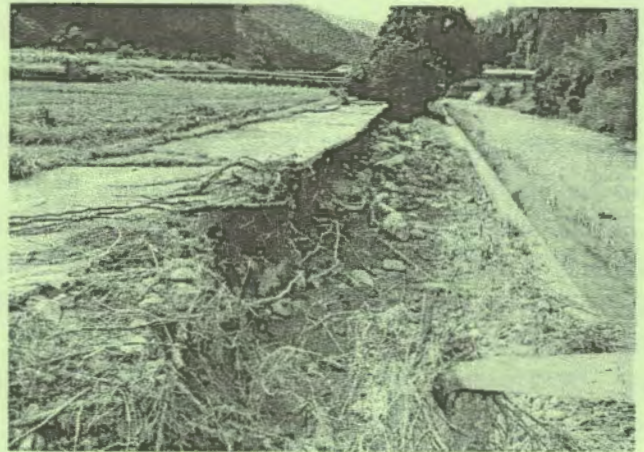
(うそ越 洗掘された農道)
